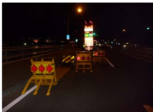
高さ6.65mの大型規制看板
